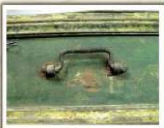
DETALLES DEL PESIMO ESTADO DE CONSERVACION
