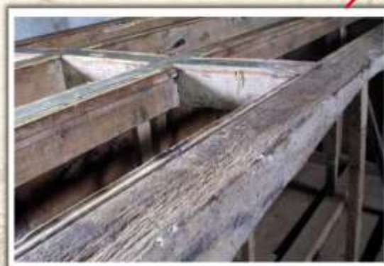
DETALLE DE LA BASE, DONDE OBSERVAMOS EL RESCACIMIENTO DE LA MADERA, PRODUCTO DEL MAL ESTADO DE CONSERVACION EN EL QUE SE ENCONTRO EL BAUL.
