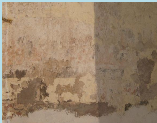
Perdida de bases de preparación
