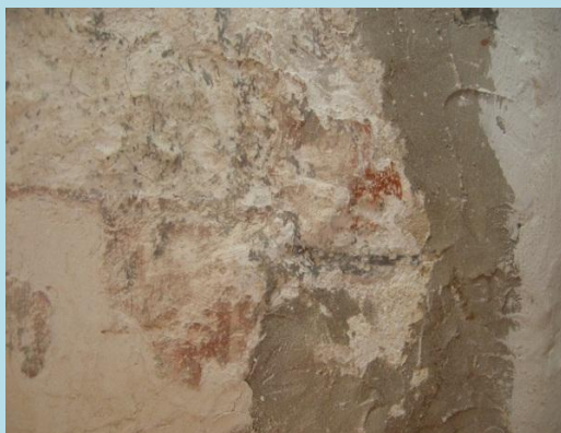
Evidencia de pintura mural
