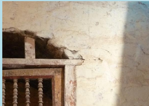
Desprendimiento de Estratos
