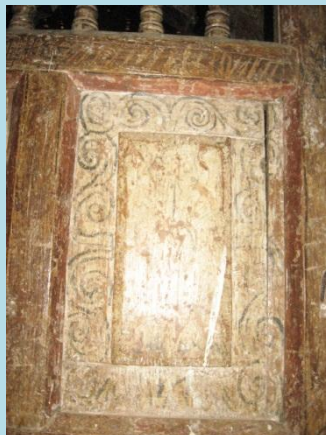
Fisuras y grietas
