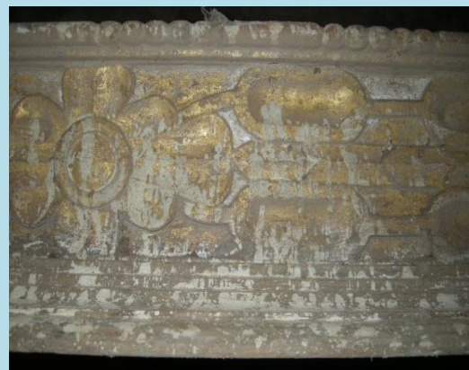
Chorreras de pintura
