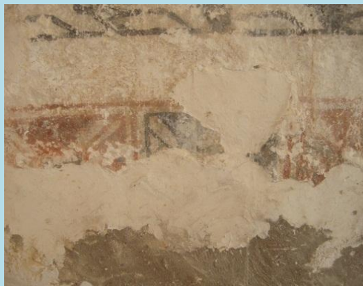
Repellados y encalados mal ejecutados
