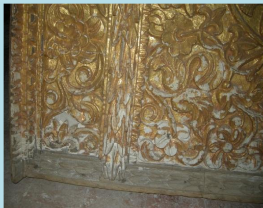
Pérdida de base de preparación
