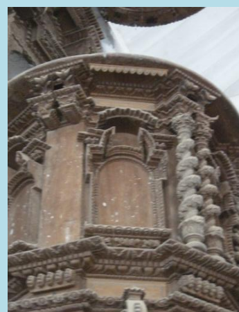
Perdida de columnas
