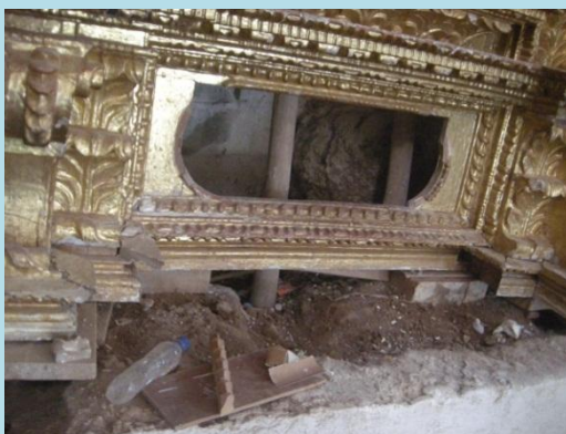
Inestabilidad estructural (banco zona lateral)
