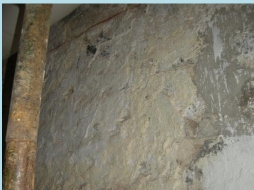
Chorreras de pintura
