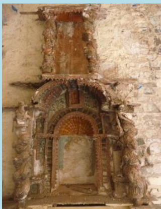
Presencia de barniz oxidado
