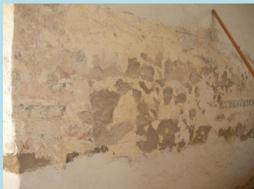
Repellado mal restituído
