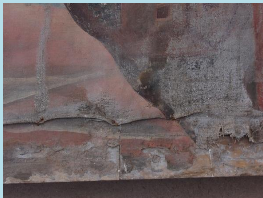
Presencia de clavos en proceso de oxidación
