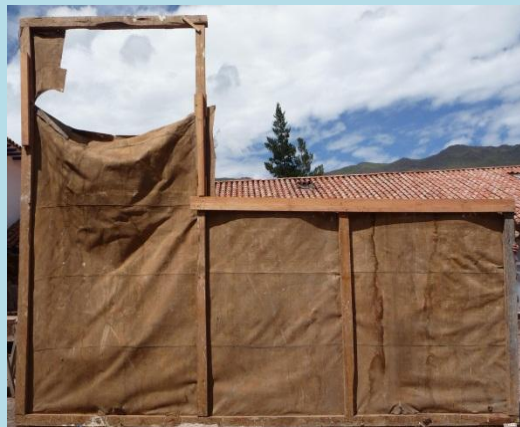
Destensado y Mutilación del soporte
