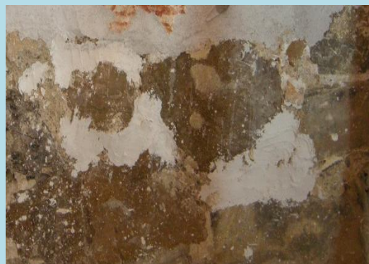
Perdida de repellado, encalado y enlucido
