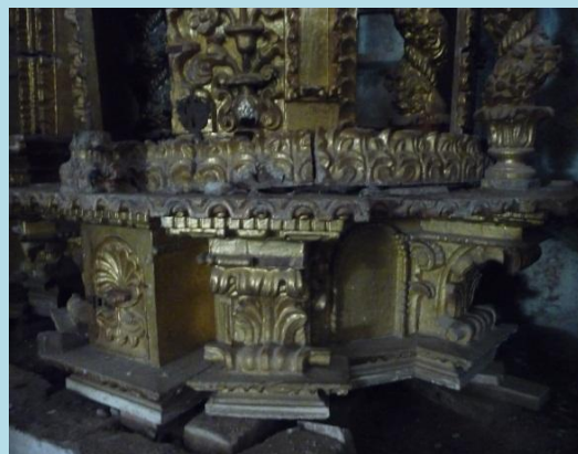
Inestabilidad estructural (banco calle central)
