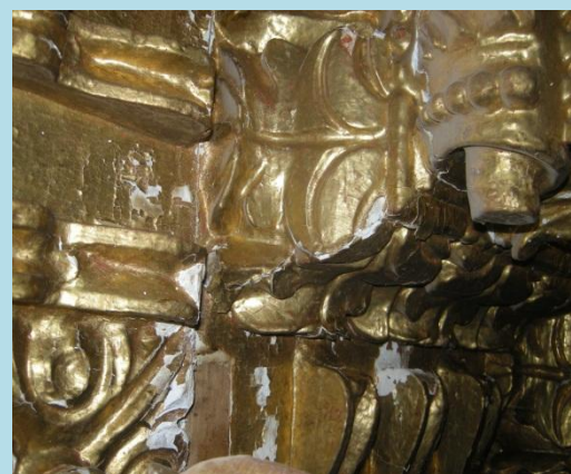
Desprendimiento de bases de preparación
