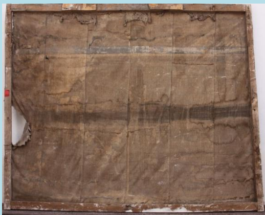
Manchas por chorreras de Agua
