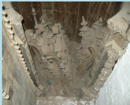
Acumulación de polvo zona interior
