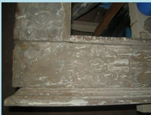
Chorreras de pintura
