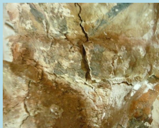
Desprendimiento de bases de preparación
