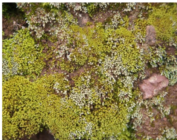
Presencia abundante de musgos en la parte exterior del recinto 6.
