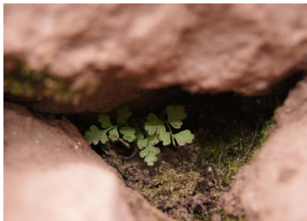
Presencia de helechos (género Blechnum ) en el mortero de las estructuras de la zona de andenes.
