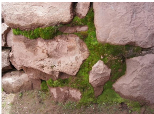
Presencia de musgos en el mortero de estructuras del recinto 1.
