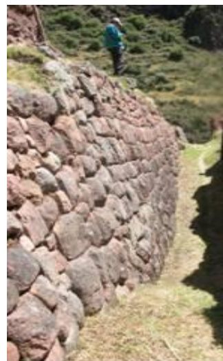
05.- Nótese la inclinación del muro
