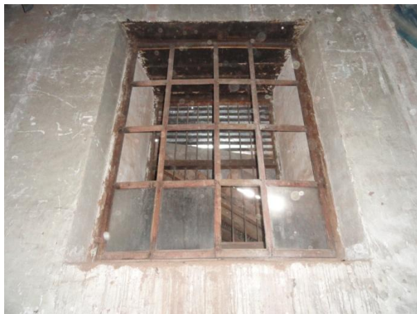
Vista 55.-Proteccion de vano a la altura del presbiterio con el tapiado de ventana que ha perdido piezas de vidrio.
