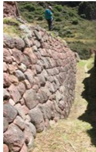
05.- Nótese la inclinación del muro
