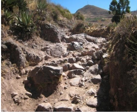
Evidencia de escalinatas deterioradas. Sector de NingrincanCHA.
