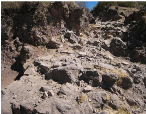
Foto N° 17: Escalinatas deterioradas, muros laterales colapsados. Sector bajada de Ningrincancha.
