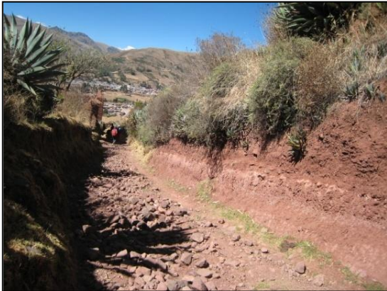
Calzada con elementos sueltos en el sector de Chaca Mayo
