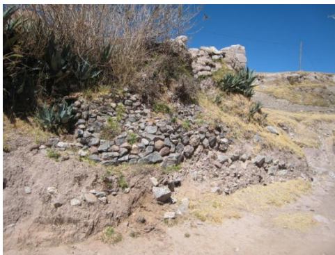
Muro lateral del camino deteriorado ingreso al, poblado de Mosocllacta
