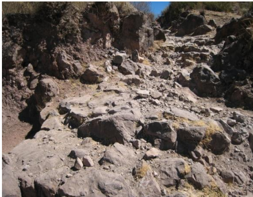
Evidencia de escalinatas deterioradas y muros laterales colapsados. Sector bajada de NingrincanCHA.
