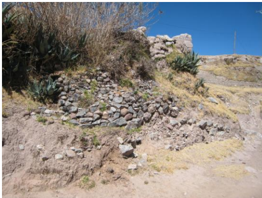
Muro lateral del camino deteriorado ingreso al poblado de Mosocllacta
