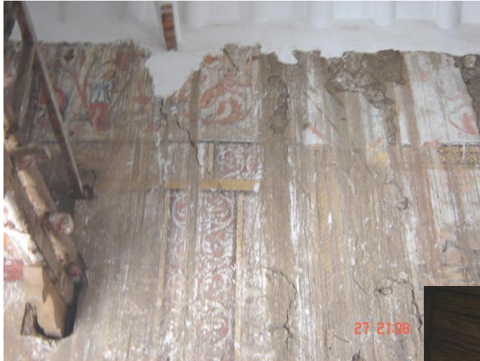
Sector de muro del evangelio área de coro fisuramientos y arrastre de pintura mural por falta de mantenimiento y cubierta de templo.
