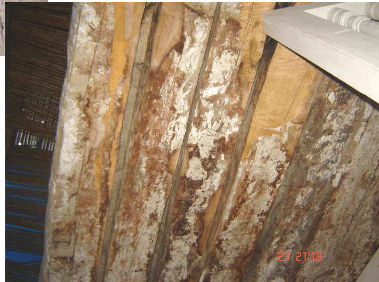
Carpintería de madera original en estado de deterioro y putrefacción, elementos que no ofrecen resistencia.
