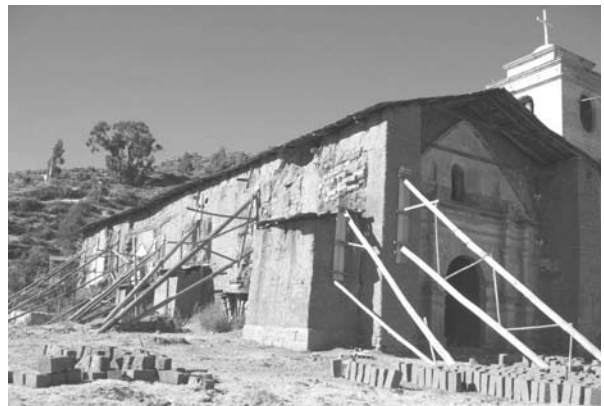
Fachada del muro del Evangelio seriamente dañada por el paso del tiempo.
