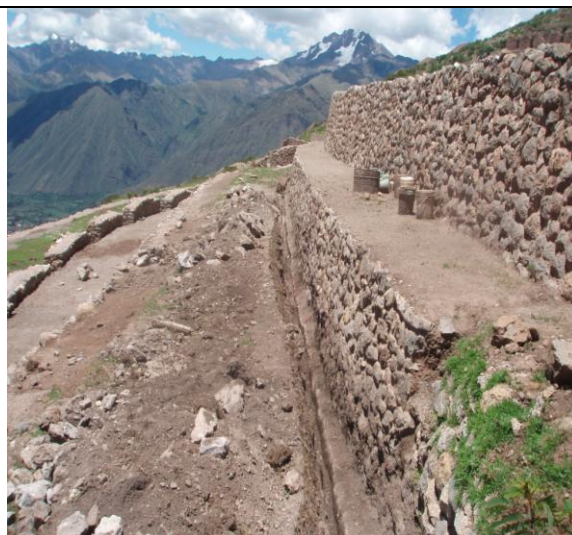
En esta vista se puede observar que los muros de contención tienen doble muro lo que indica que no es muy estable el terreno de esta parte del sector B.
