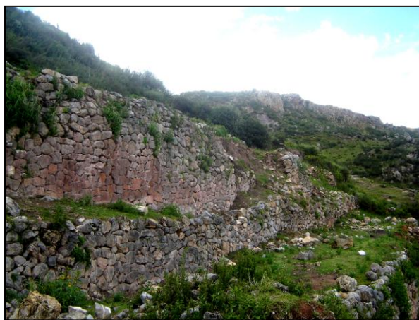
Foto N° 10.- Colapsamiento del muro de contención ubicado entre el recinto B-1 Y B-2
