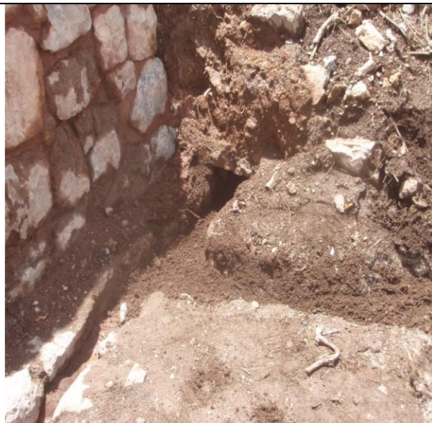
Se observa el canal de drenaje, la misma que esta obstruida evitando que las aguas pluviales discurran.
