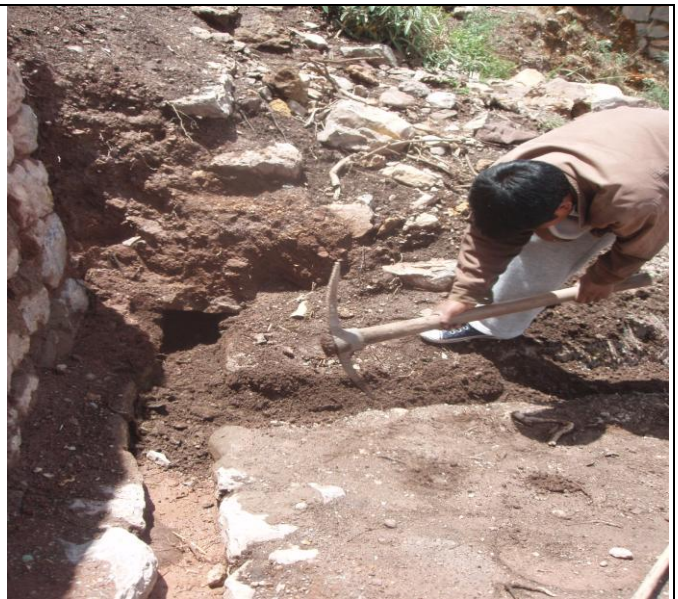
Razón por la cual se apertura un canal adicional con la finalidad de que no se empoce y provoque problemas en los muros aledaños..
