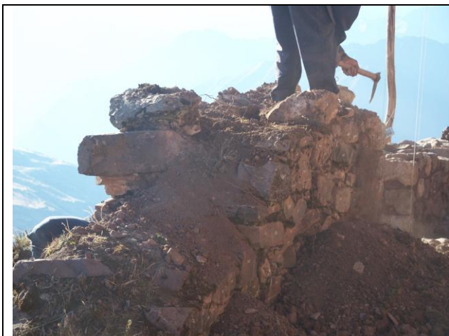
Desmontado de muro plagado de raíces en el núcleo, los mismos que perjudican la estructura del mismo.
