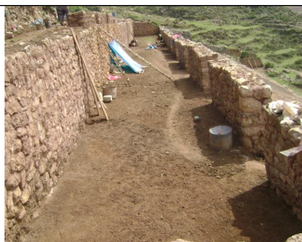
En esta vista se puede notar que falta la cubertina de protección e los muros.
