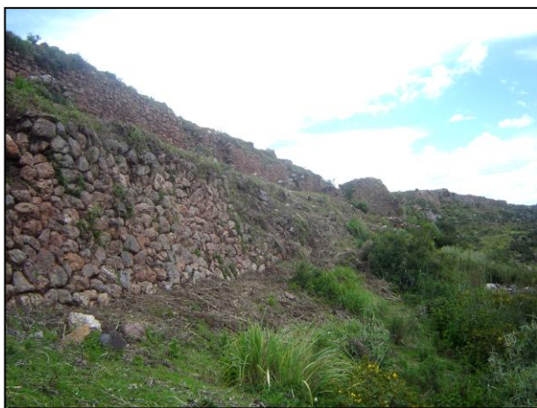
Foto N° 09.- Colapsamiento del muro de contención ubicado entre el recinto B-13 y B-14
