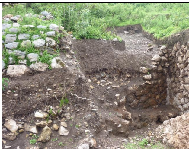
Se observa el muro original a punto de colapsar, Recinto N° 8.
