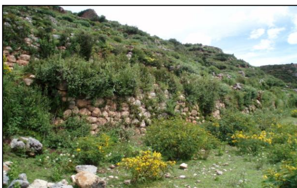
Foto N° 07.- Vista de la abundante vegetación que se encuentra cubriendo los recintos
