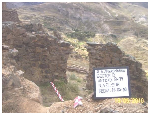
Vista del estado en que se registro, con paramentos colapsados en 60%
