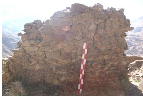
Vista actual del estado del paramento recinto 81
