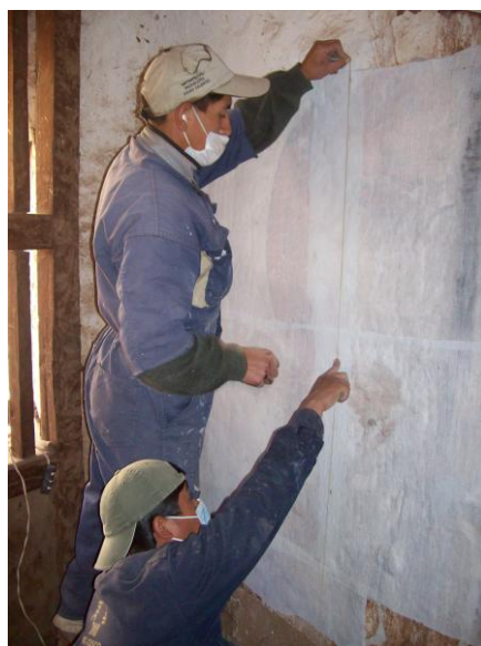
Velado de pintura mural, en muro lado evangelio sector sotocoro.
